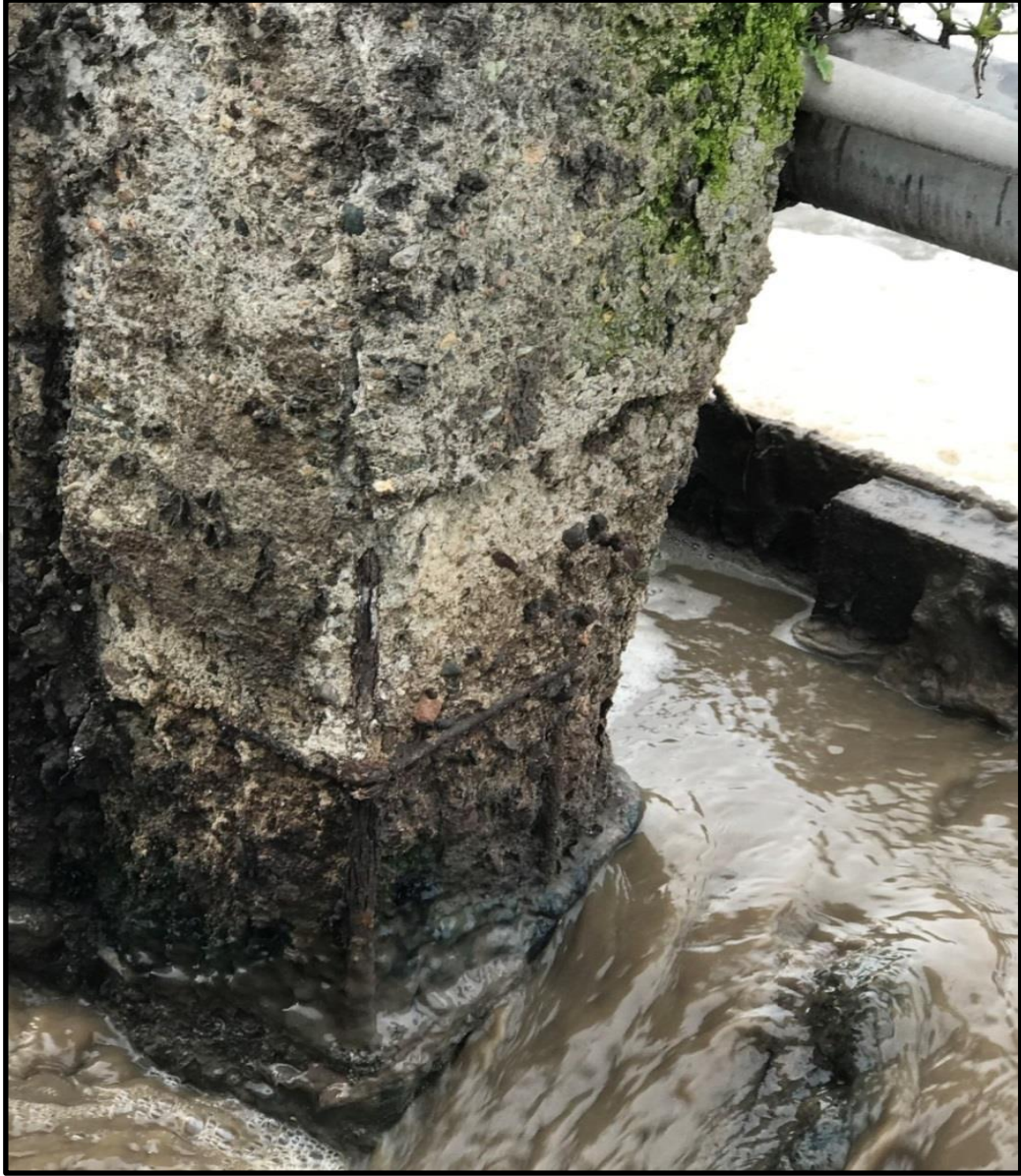
Şekil 4.5. Havalandırma Havuzu Çıkışı Perde Duvarlarındaki Hasarlar (Çorum)
