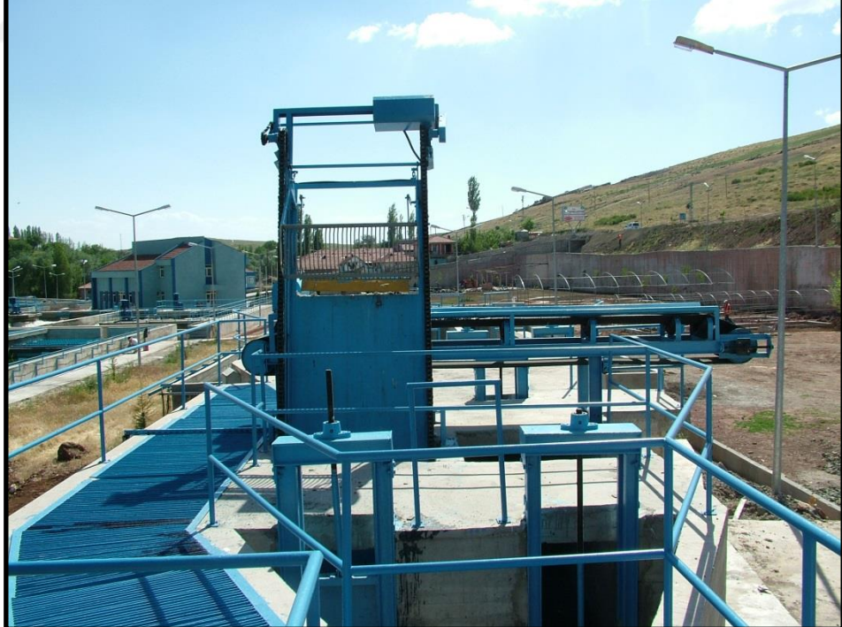
Şekil 3.7. Yozgat Atıksu Arıtma - Tesisi İnce Izgara
