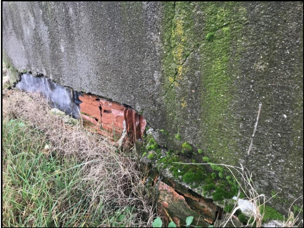
Şekil 4.3. Giriş Kanalı Beton Yüzeyindeki Hasarlar (Çorum)
