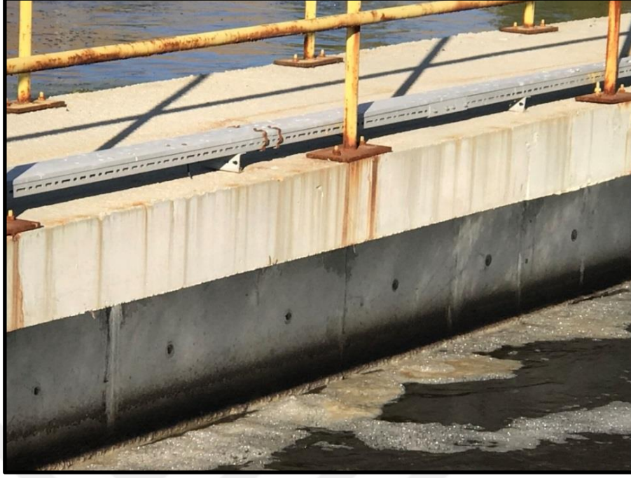
Şekil 4.18. Havalandırma Havuzu Bağlantı Elemanlarındaki ve Betonarme Elemanlarındaki Bozulmalar (Nevşehir)
