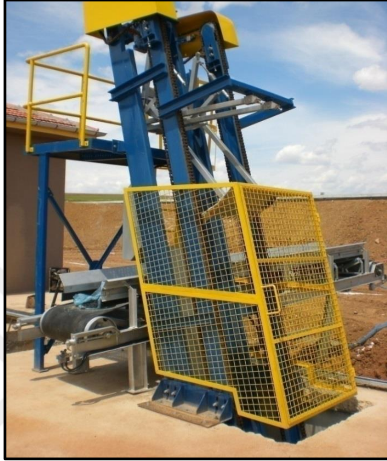
Şekil 3.41. Kırşehir Atıksu Arıtma Tesisi – Giriş Yapısı
