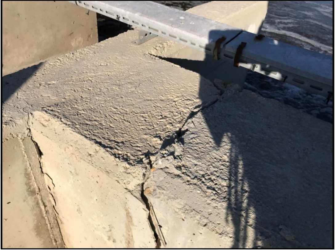
Şekil 4.32. Çamur Yoğunlaştırma Havuzu Perde Duvarı Hasarları (Nevşehir)
