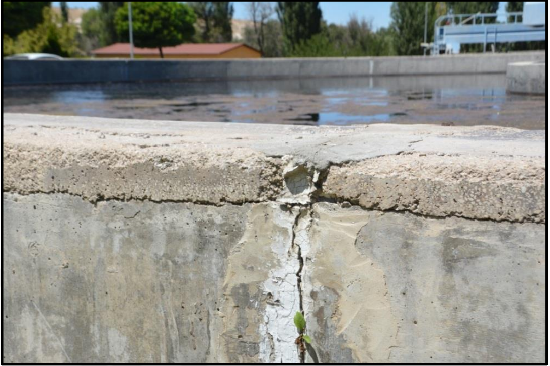
Şekil 4.30. Çamur Yoğunlaştırma Havuzu Perde Duvarlarındaki Hasarlar (Nevşehir)
