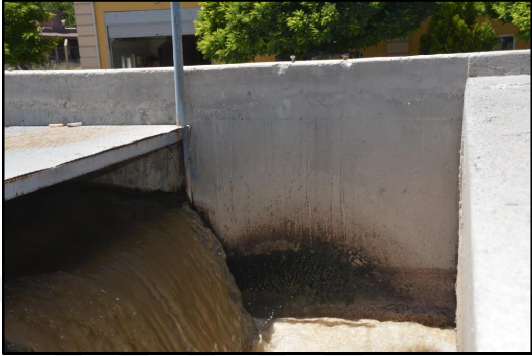
Şekil 4.2. Ön Çökeltme Havuzu Giriş Yapısı Beton Yüzeyindeki Hasarlar (Nevşehir)
