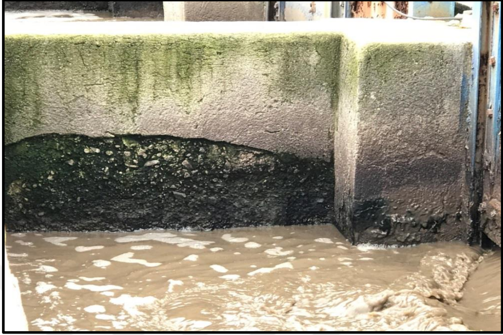
Şekil 4.20. Havalandırma Havuzu Çıkışı Perde Duvarlarındaki Hasarlar (Kırşehir)
