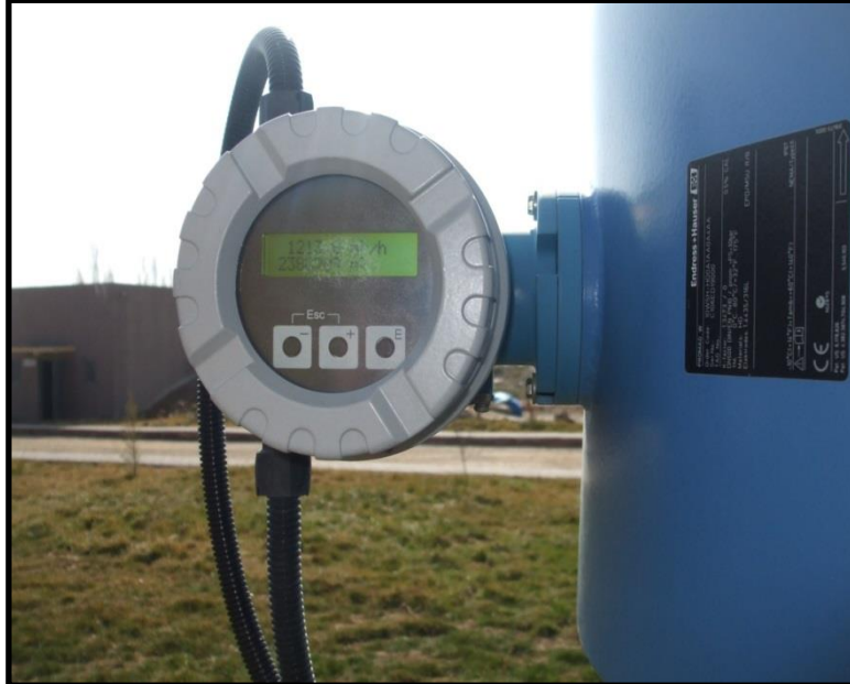
Şekil 3.42. Kırşehir Atıksu Arıtma Tesisi – Debitre
