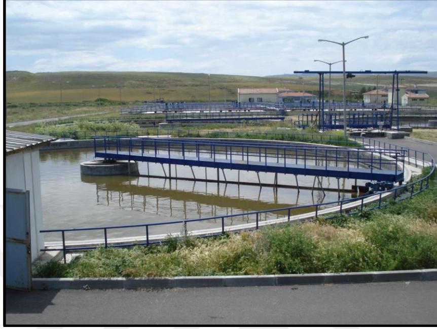
Şekil 3.57. Çorum Atıksu Arıtma Tesisi – Son Çökeltme Havuzları
