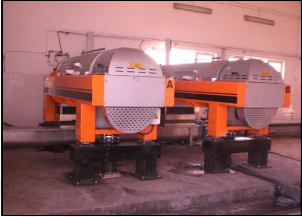
Şekil 3.62. Çorum Atıksu Arıtma Tesisi – Çamur Susuzlaştırma Ünitesi
