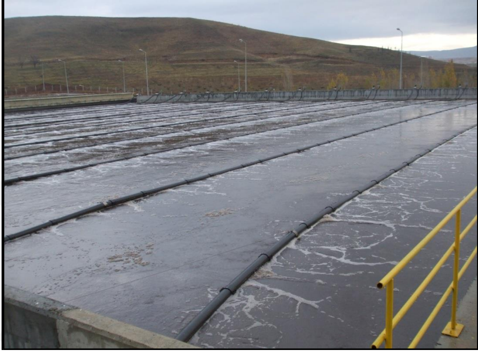
Şekil 3.46. Kırşehir Atıksu Arıtma Tesisi – Havalandırma Havuzları
