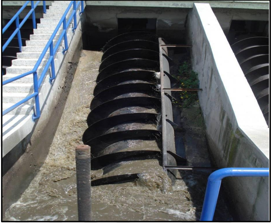
Şekil 3.54. Çorum Atıksu Arıtma Tesisi – Burgu Pompa
