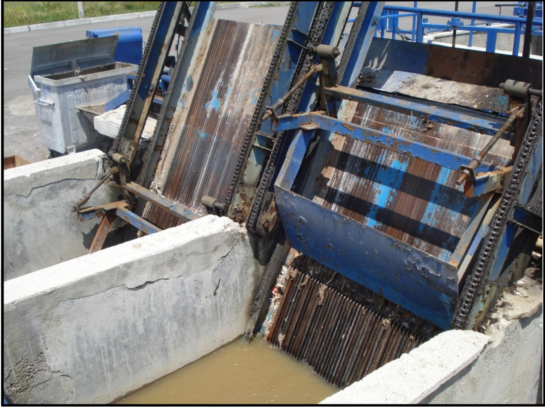
Şekil 3.50. Çorum Atıksu Arıtma Tesisi – Izgaralar
