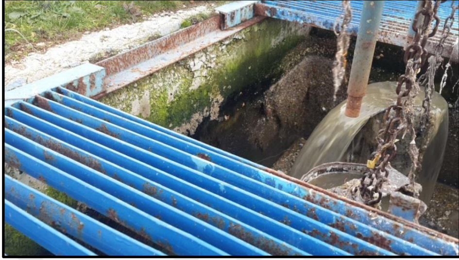
Şekil 4.38. Ön Çökeltme Çamur Alma Kanalı Hasarları (Yozgat)
