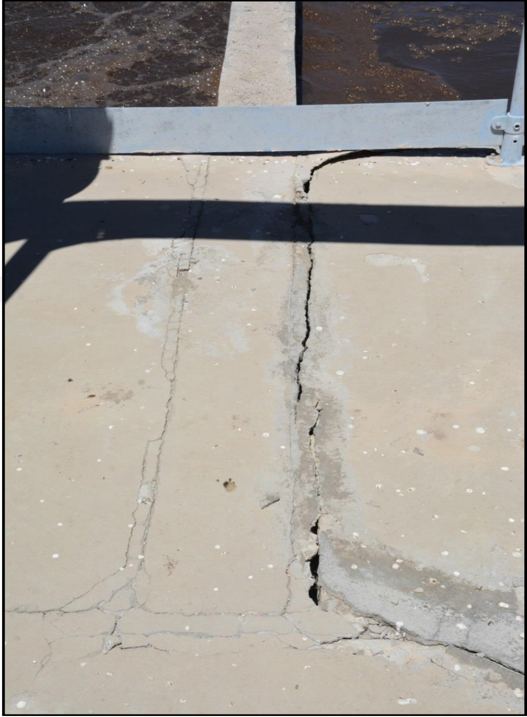
Şekil 4.34. Havalandırma Havuzu Tabliye Betonundaki Hasarlar (Nevşehir)
