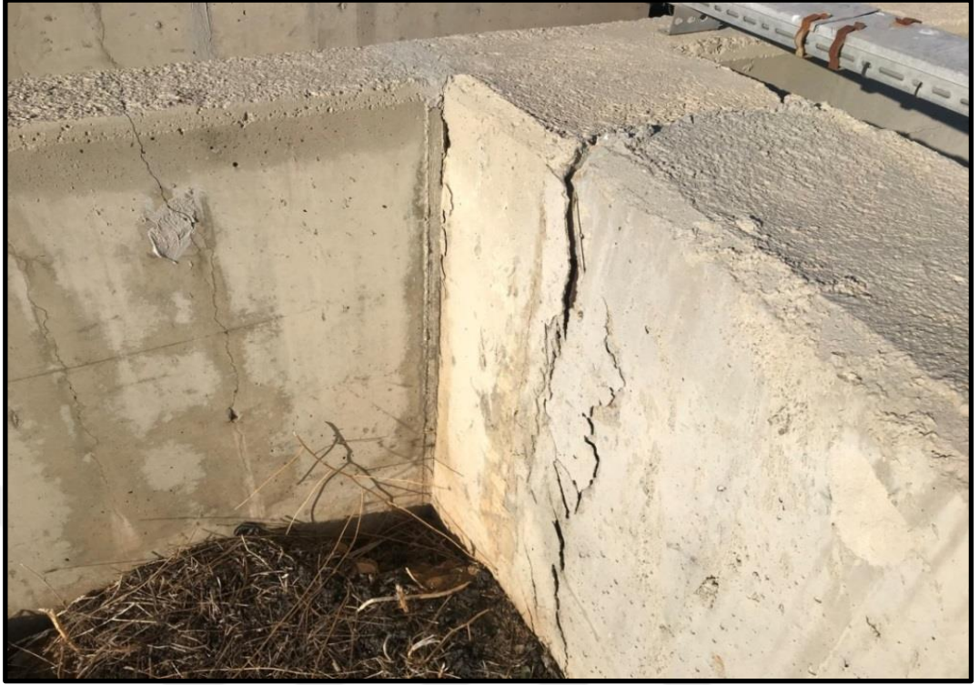
Şekil 4.35. Çamur Yoğunlaştırma Havuzu Perde Duvarı Hasarları (Nevşehir)
