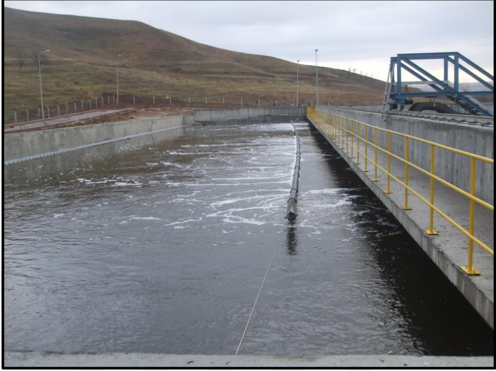
Şekil 3.47. Kırşehir Atıksu Arıtma Tesisi – Çöktürme Havuzları
