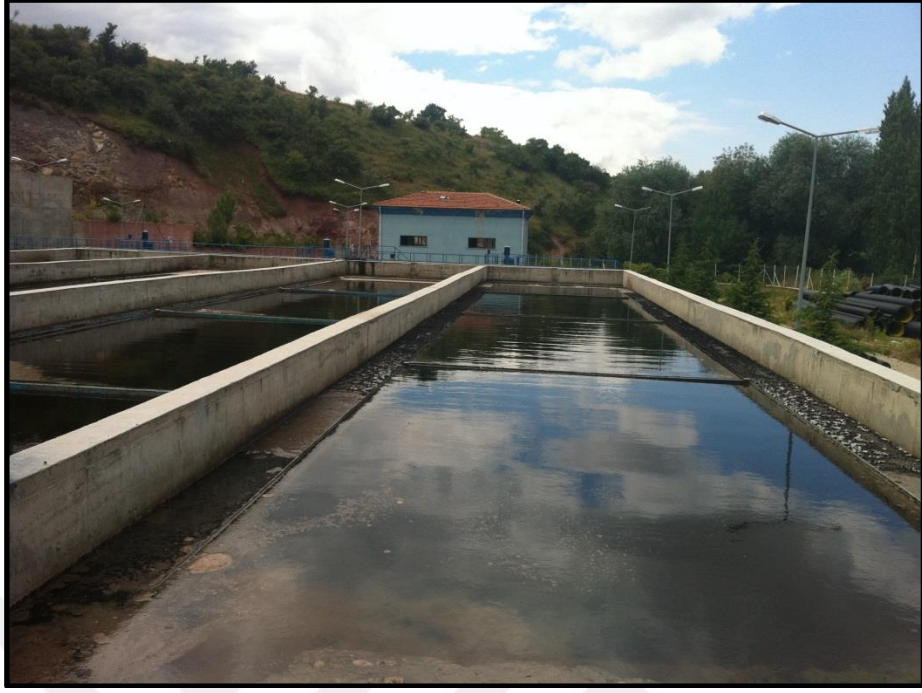
Şekil 3.13. Yozgat Atıksu Arıtma Tesisi – Son Çökeltme Havuzu
