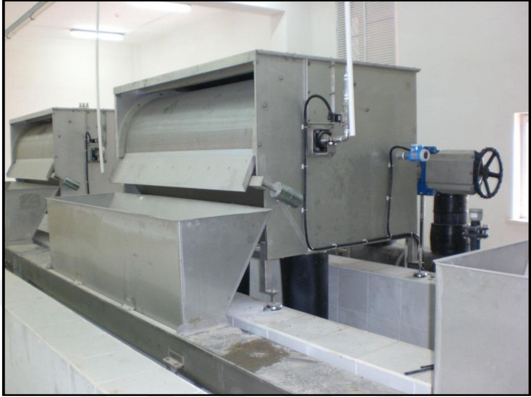
Şekil 3.43. Kırşehir Atıksu Arıtma Tesisi – Izgaralar
