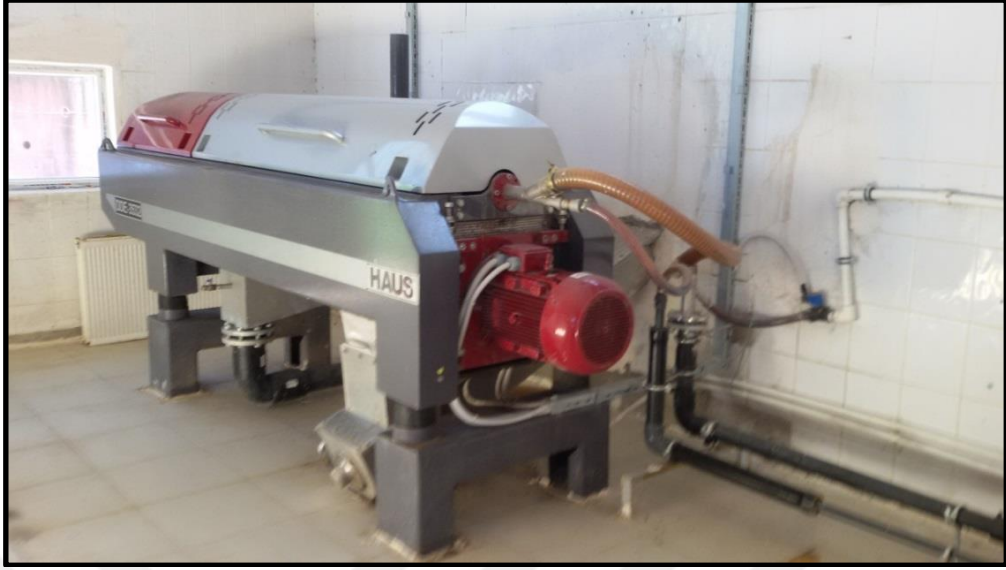
Şekil 3.19. Yozgat Atıksu Arıtma Tesisi – Çamur Susuzlaştırma Ünitesi – Dekantör
