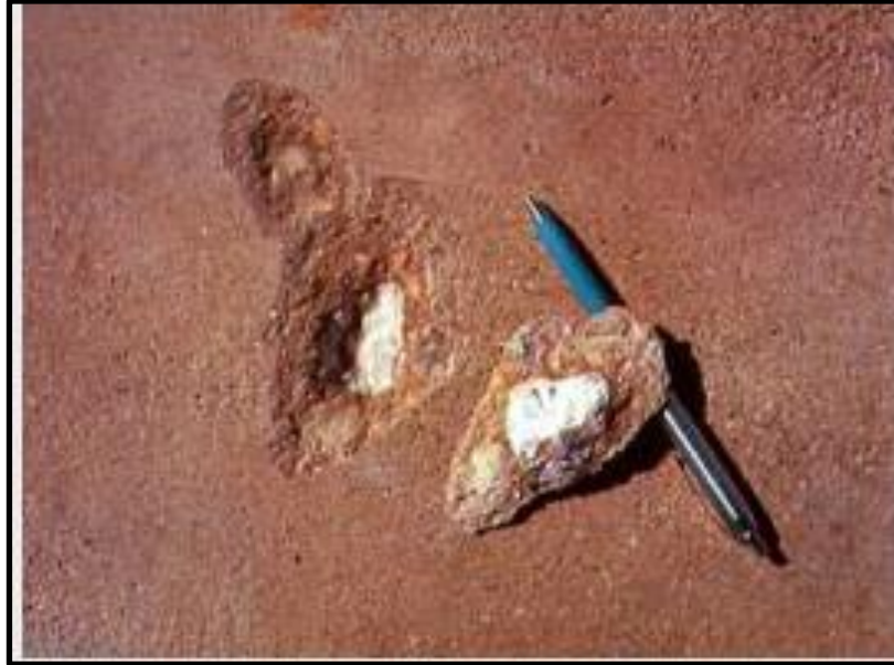
Şekil 2.16. Beton Yüzeyinde Kopma [1]
