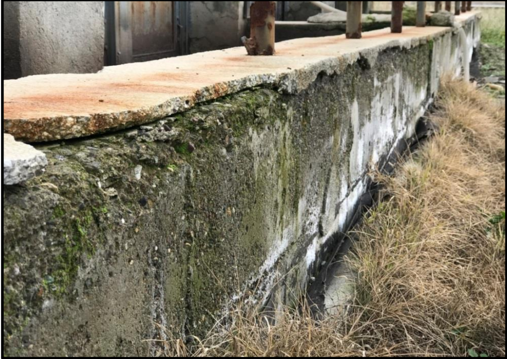
Şekil 4.23. Havuz Duvarlarındaki Hasarlar (Kırşehir)
