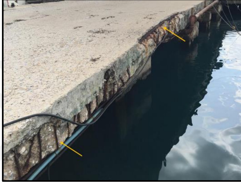
Şekil 2.34. Deniz Kenarındaki Donatının Tuz Etkisi ile Korozyonu [7]
