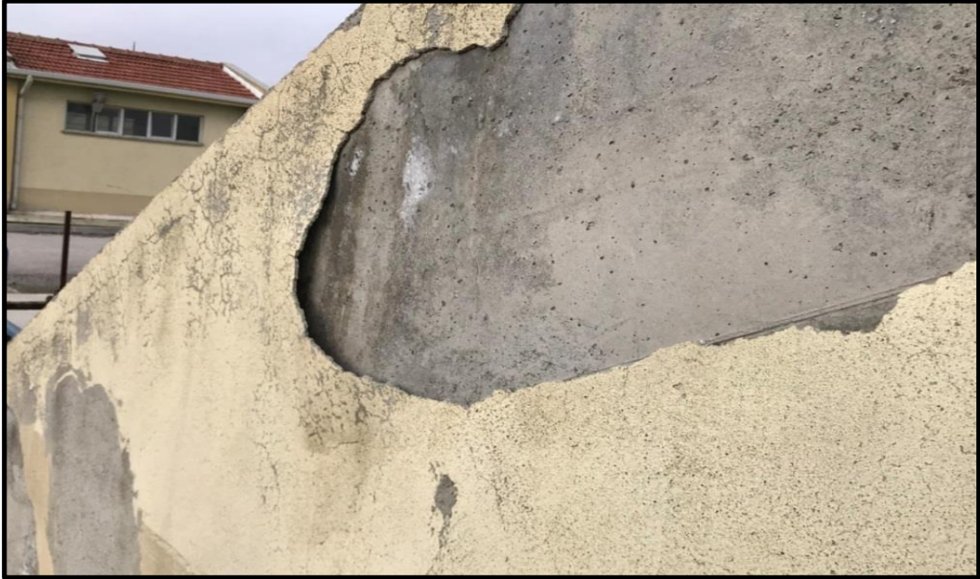
Şekil 4.21. Perde Sıvalarındaki Hasarlar (Çorum)
