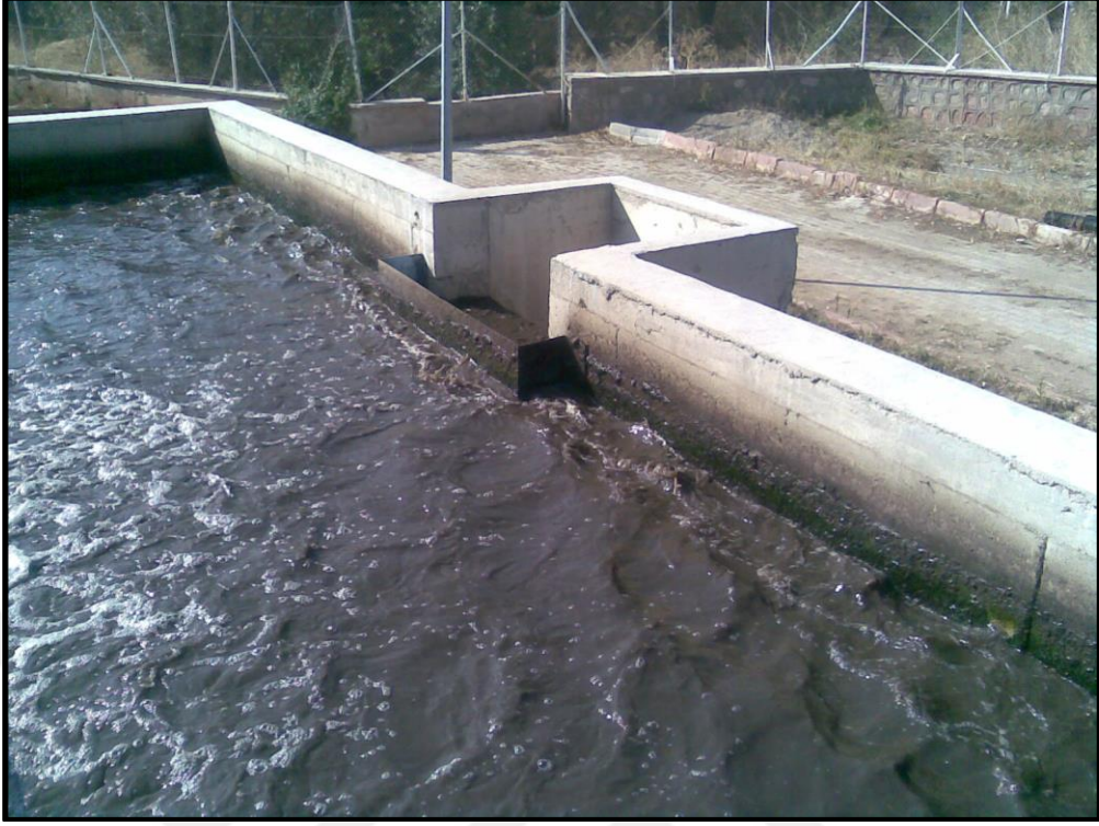
Şekil 3.18. Yozgat Atıksu Arıtma Tesisi – Çamur Çürütme Havuzu
