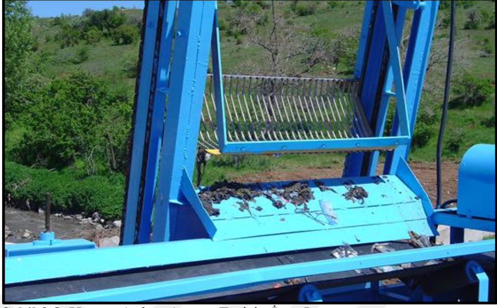
Şekil 3.8. Yozgat Atıksu Arıtma Tesisi - İnce Izgara
