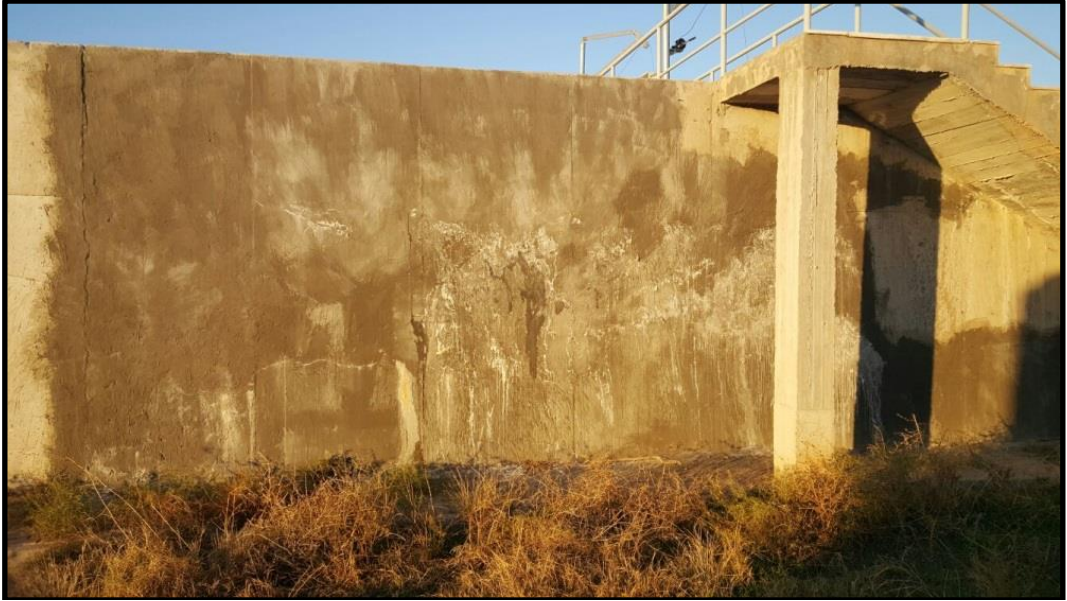
Şekil 4.26. Çamur Yoğunlaştırma Havuz Duvarındaki Hasarlar (Nevşehir)
