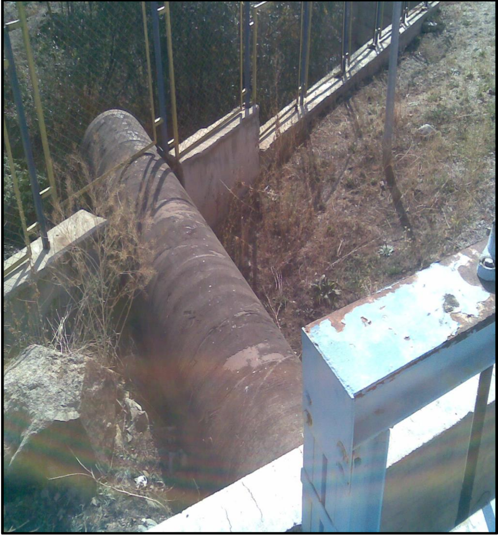
Şekil 3.5. Yozgat Atıksu Arıtma Tesisi - By-Pass Hattı
