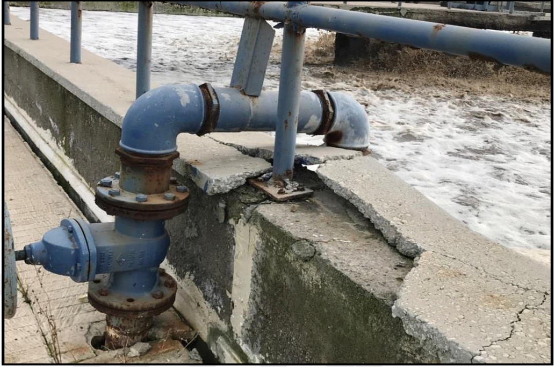
Şekil 4.12. Havalandırma Havuzu Perde Beton Küpeştelerindeki Hasarlar (Çorum)
