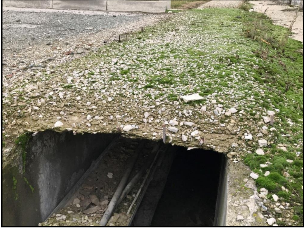
ekil 4.10. Kablo Kanallarının Beton Kapaklarında Meydana Gelmi Hasarlar (orum)
