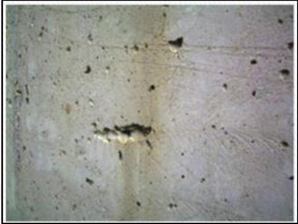
Şekil 2.28. Yüzeyde Oluşan Boşluklar [1]
