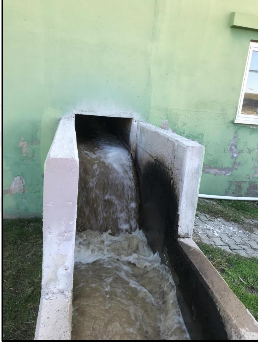
Şekil 4.1. Giriş Kanalı Beton Yüzeyindeki Hasarlar (Kırşehir)
