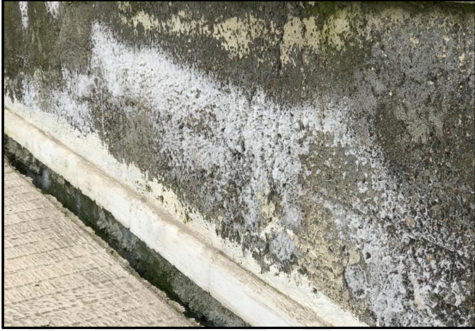
Şekil 4.14. Çamur Yoğunlaştırma Havuzu Perde Duvarındaki Hasarlar (Çorum)
