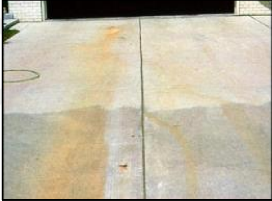
Şekil 2.17. Beton Yüzeyinde Renk Değişikliği [1]
