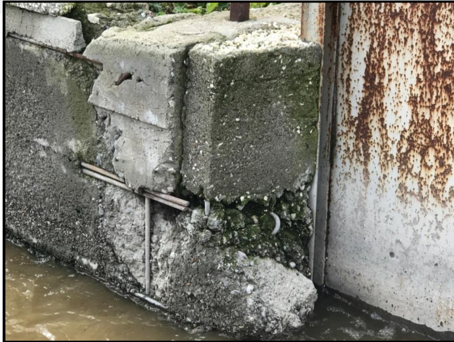
Şekil 4.9. Giriş Kanalı Perde Duvarlarındaki Bozulma ve Hasarlar (Kırşehir)
