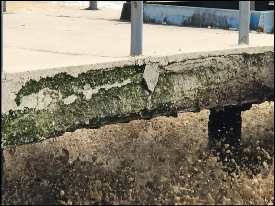
Şekil 4.7. Havalandırma Havuzu Duvarlarında Meydana Gelmiş Hasarlar (Yozgat)
