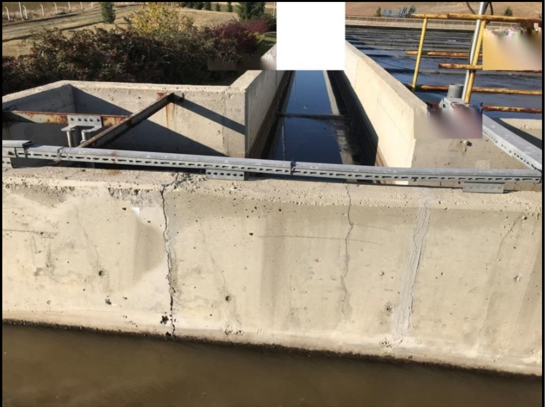
Şekil 4.31. Ön Çökeltme Havuzu Perde Duvarlarındaki Hasarlar (Nevşehir)
