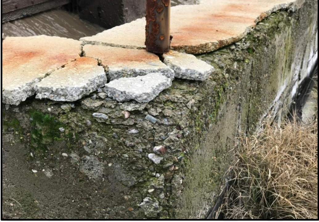
Şekil 4.22. Havuz Duvarlarındaki Hasarlar (Kırşehir)
