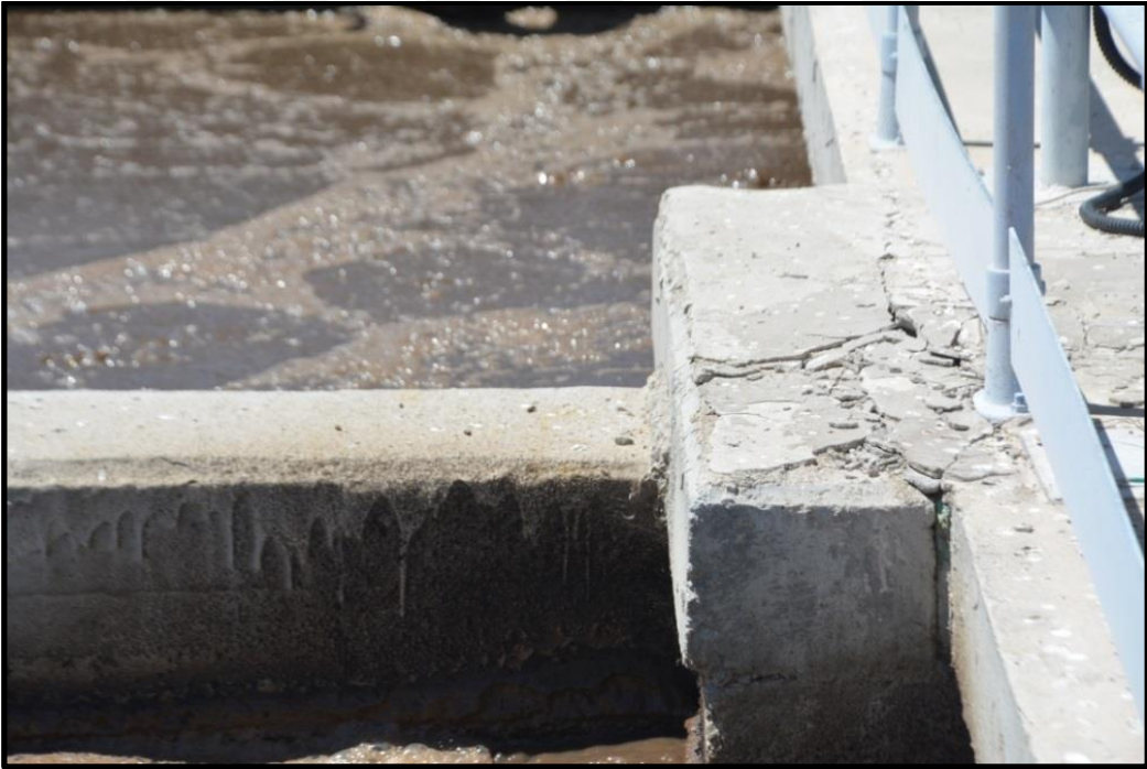
Şekil 4.29. Havalandırma Havuzu Perde Duvarlarındaki Hasarlar (Nevşehir)
