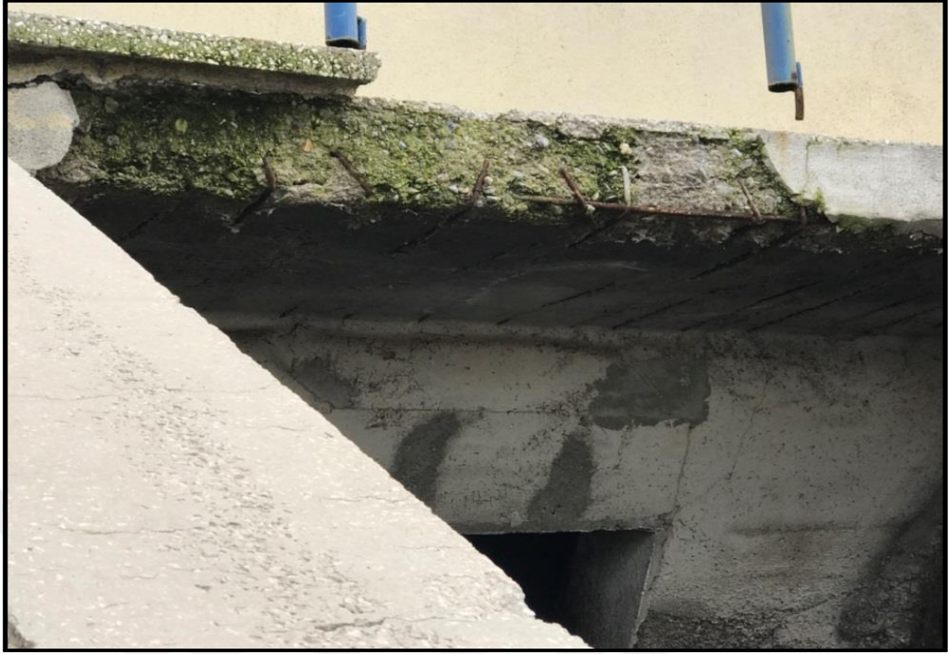
Şekil 4.16. İzgara ve Kum Tutucu Binası Yürüyüş Yolu Tablalarındaki Hasarlar (Çorum)
