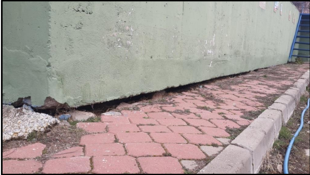
Şekil 4.39. Havuzlarda Oturma Hasarları (Yozgat)
