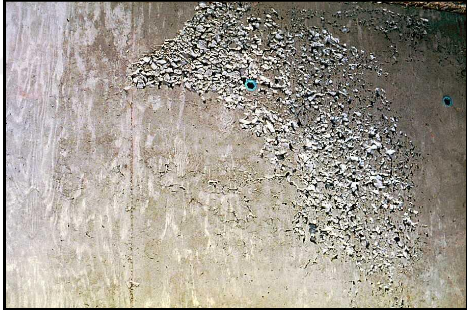
Şekil 2.29. Yüzeyde Oluşan Boşluklar [1]
