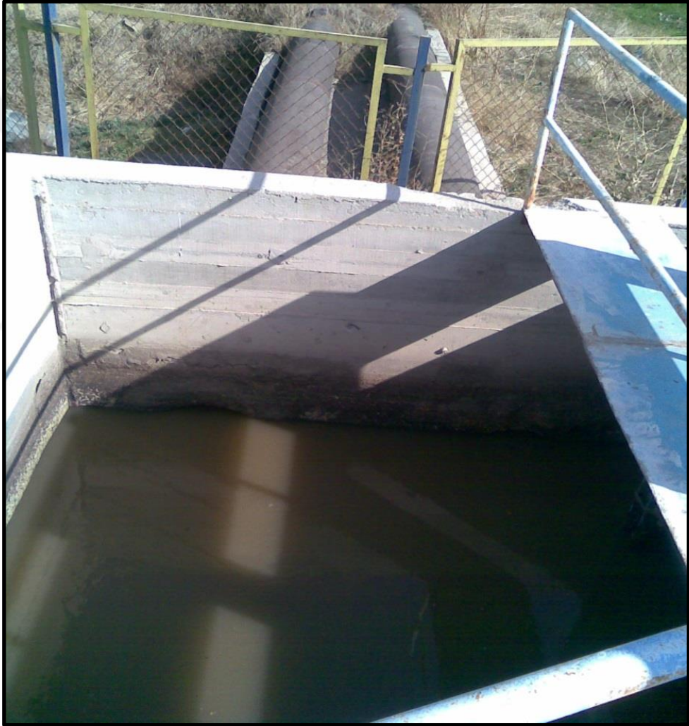
Şekil 3.4. Yozgat Atıksu Arıtma Tesisi - Giriş Kanalı
