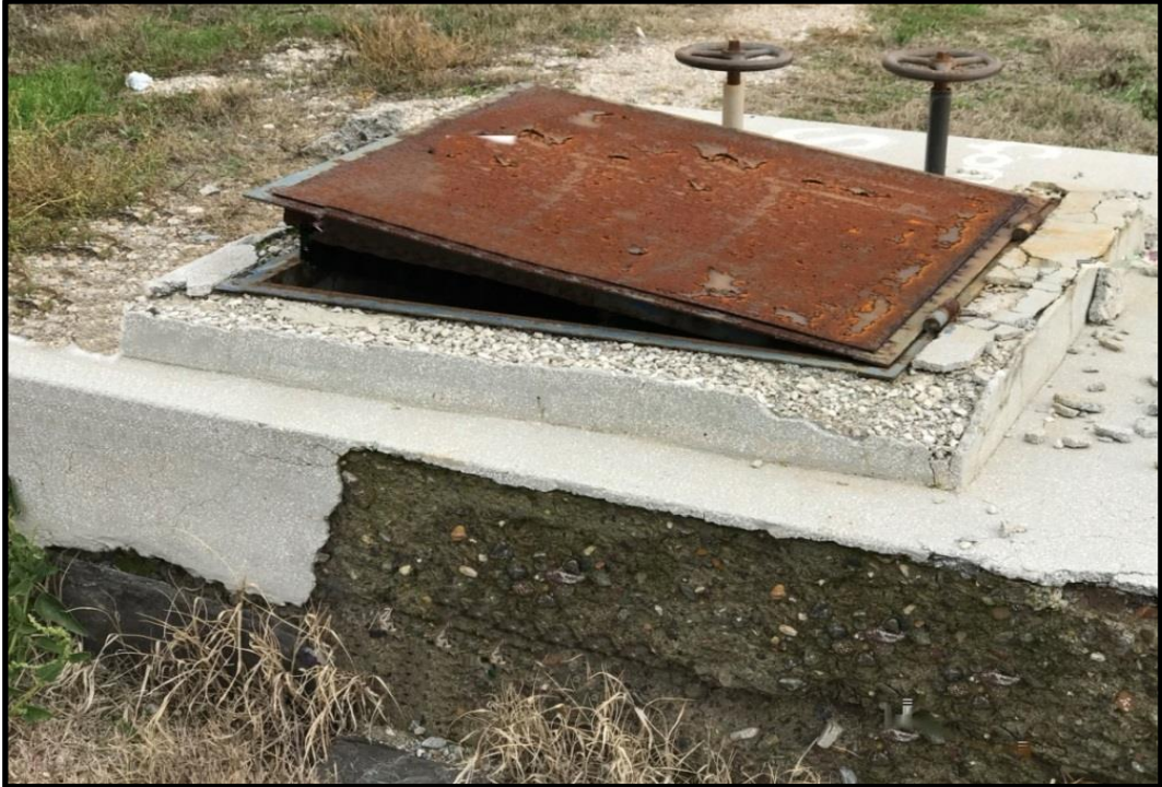
Şekil 4.17. Çamur Alma Deposundaki Hasarlar (Kırşehir)
