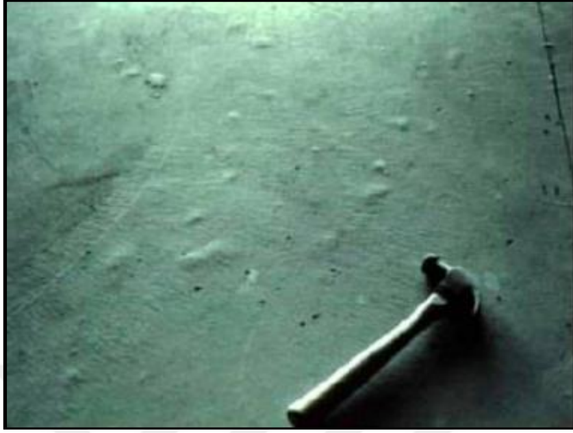
Şekil 2.15. Beton Yüzeyinde Kabarma [1]
