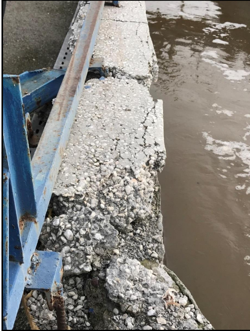
Şekil 4.24. Havuz Duvarlarındaki Hasarlar (Çorum)
