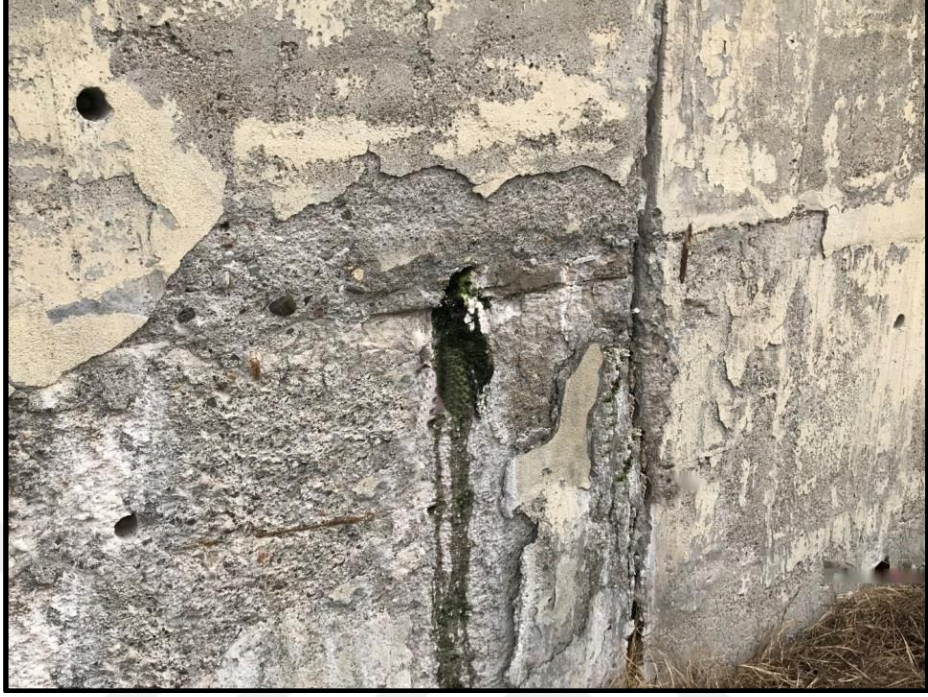
Şekil 4.25. Çamur Havuzundaki Hasarlar (Yozgat)
