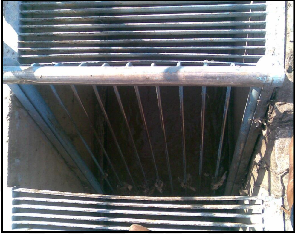
Şekil 3.6. Yozgat Atıksu Arıtma Tesisi - Kaba Izgara
