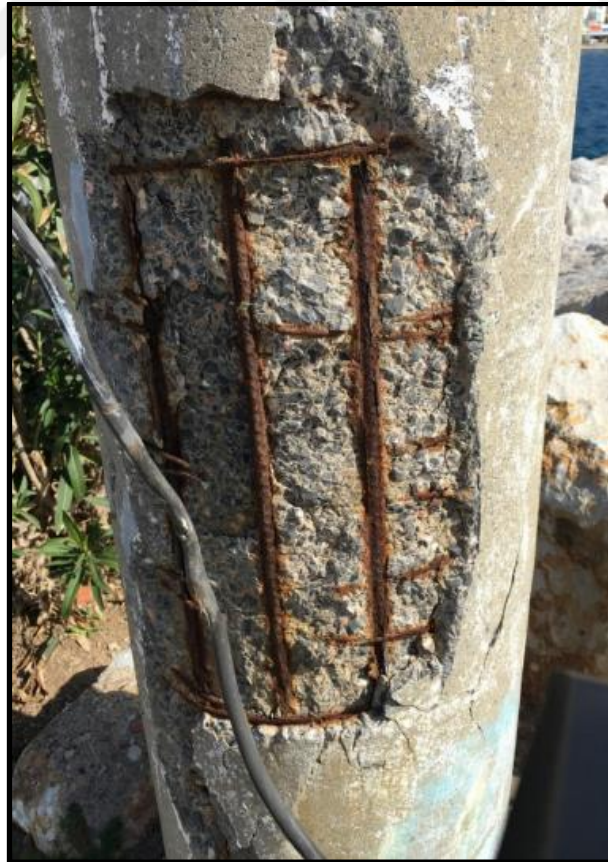
Şekil 2.33. Korozyona Maruz Kalmış Betonarme Elektrik Direği [2]
