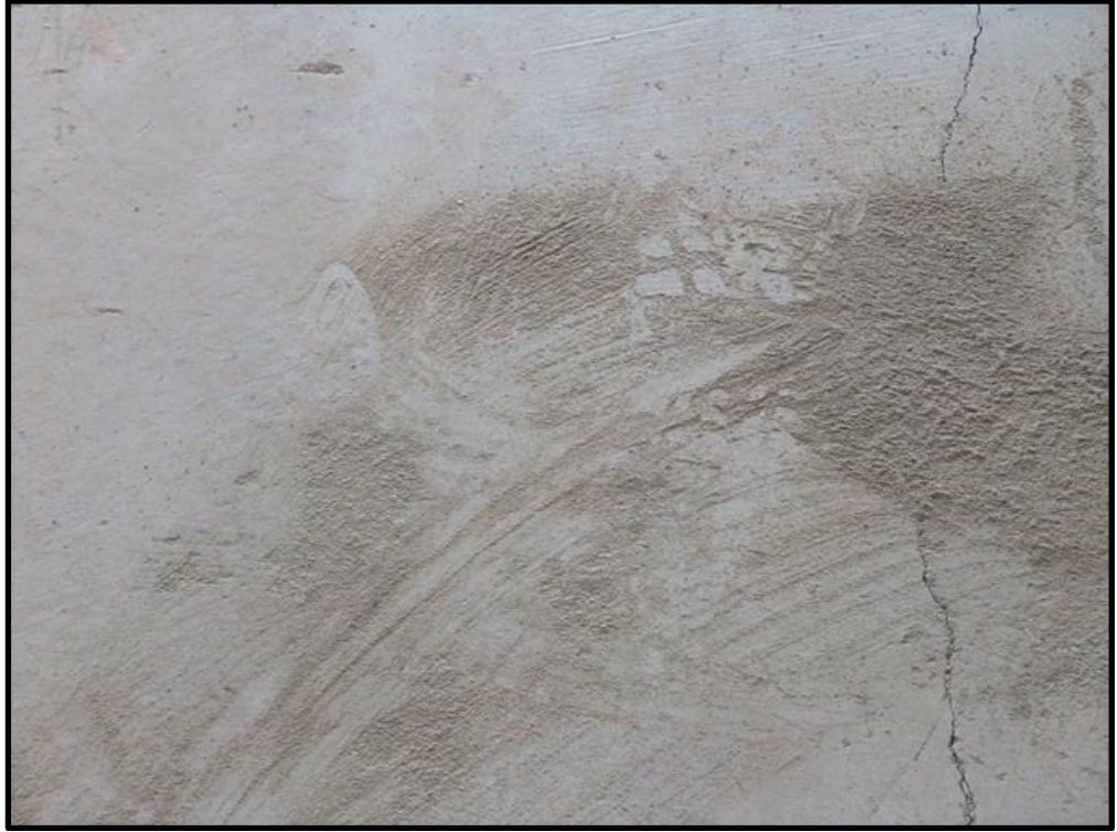
Şekil 2.13. Beton Yüzeyinde Tozuma [1]
