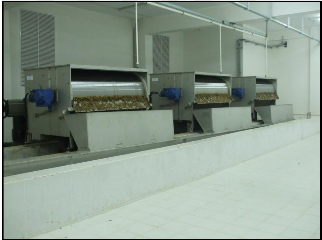
Şekil 3.44. Kırşehir Atıksu Arıtma Tesisi – Izgaralar
