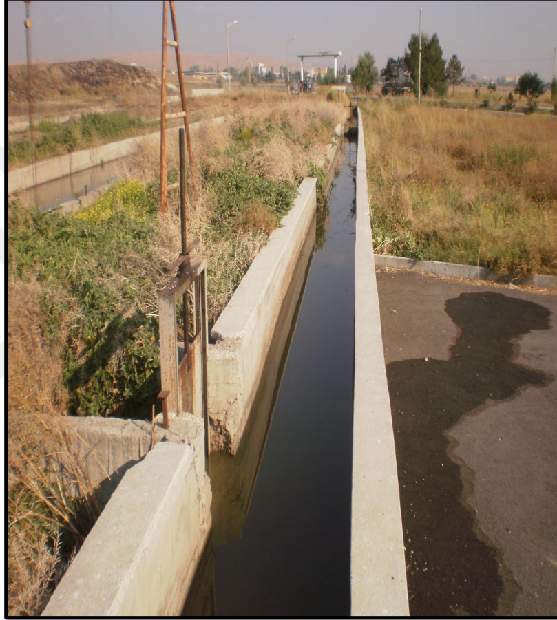
Şekil 3.49. Çorum Atıksu Arıtma Tesisi – Giriş Yapısı
