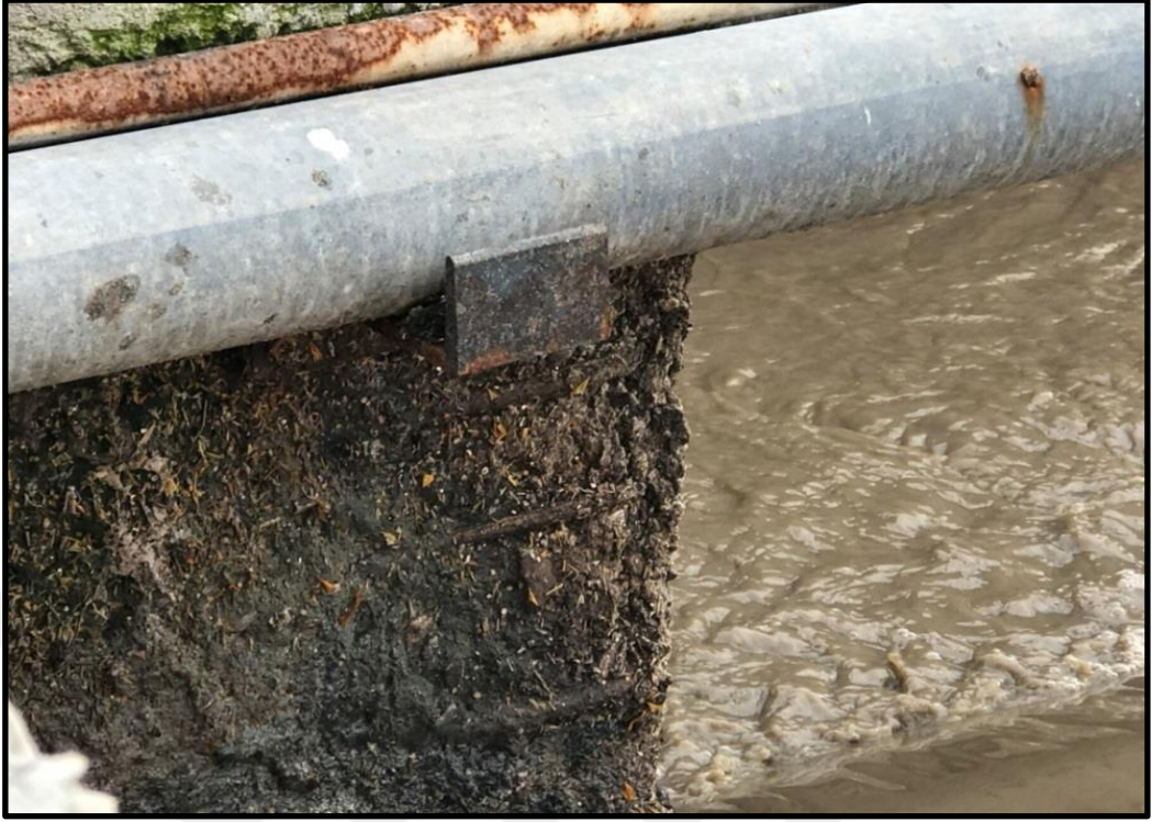
Şekil 4.6. Havalandırma Havuzu Perde Duvarlarındaki Hasarlar (Kırşehir)
