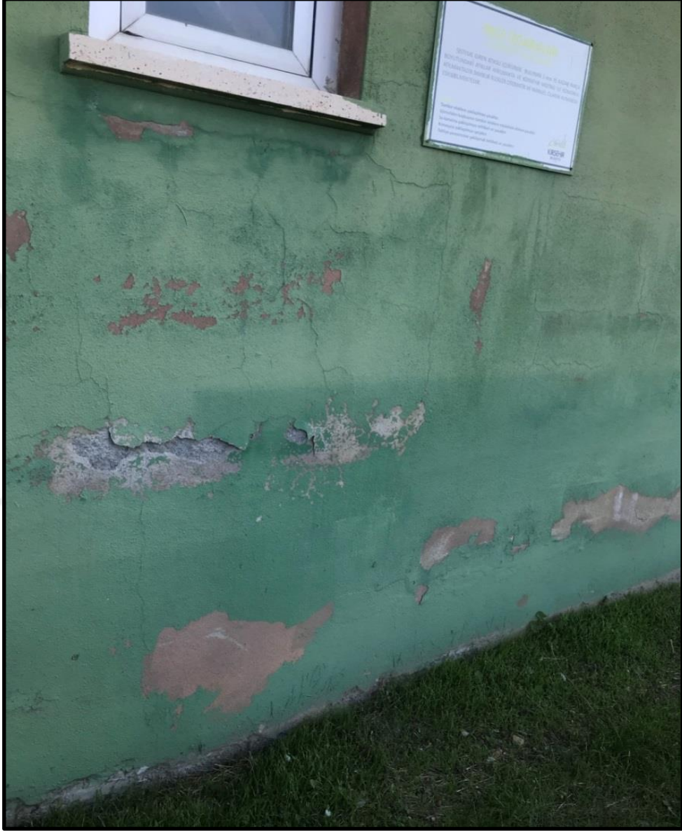
Şekil 4.27. Izgara ve Kum Tutucu Ünitelerin Bulunduğu Binadaki Hasarlar (Kırşehir)
