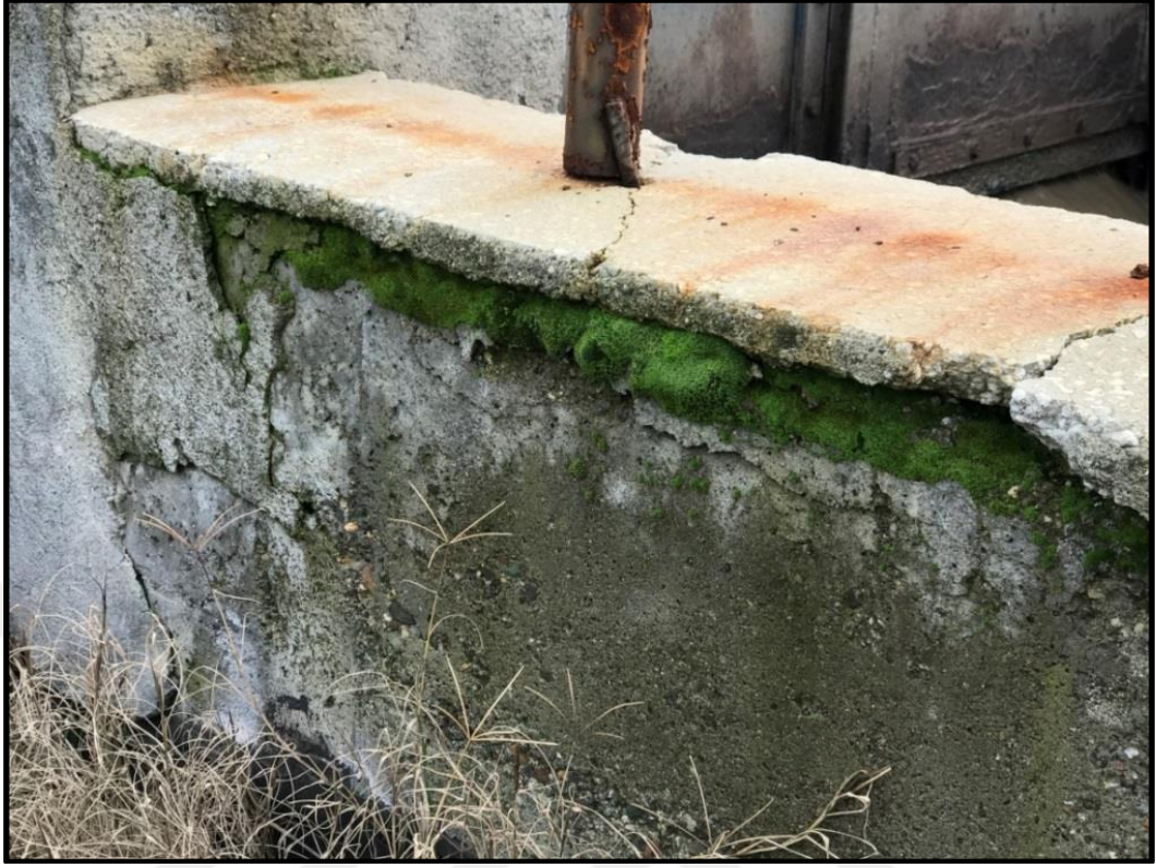
Şekil 4.4. Giriş Kanalı Beton Duvar Yüzeyindeki Hasarlar (Yozgat)
