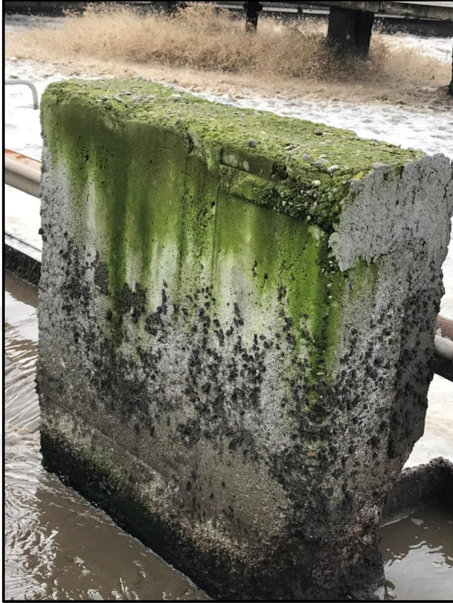
Şekil 4.13. Havalandırma Havuzu Çıkışı Perdelerindeki Hasarla (Çorum)
