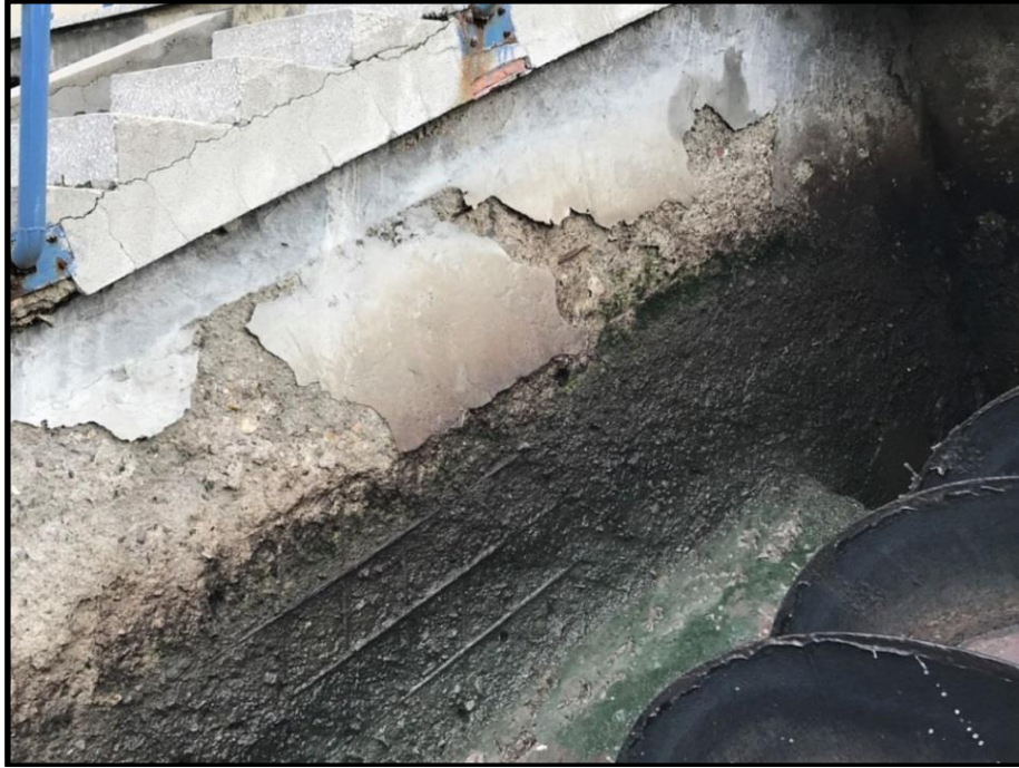
Şekil 4.19. Pompa Kanalı Beton Duvarlarındaki Hasarlar (Çorum)
