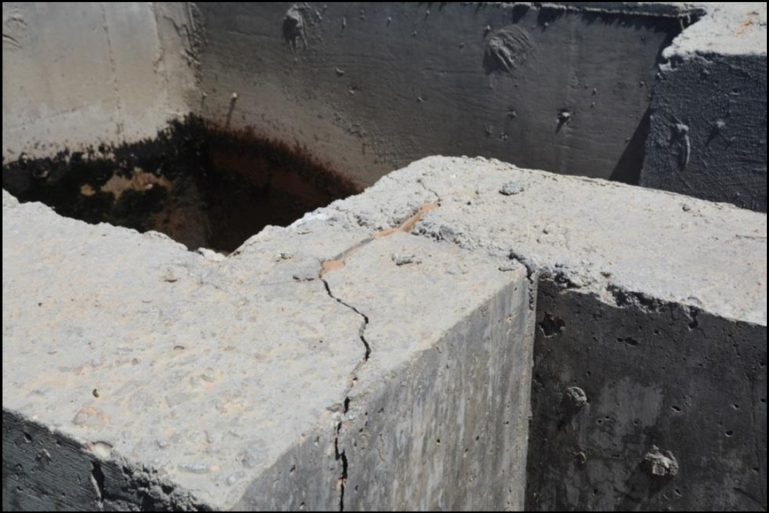
Şekil 4.33. Havalandırma Havuzu Perde Duvarlarındaki Hasarlar (Nevşehir)
