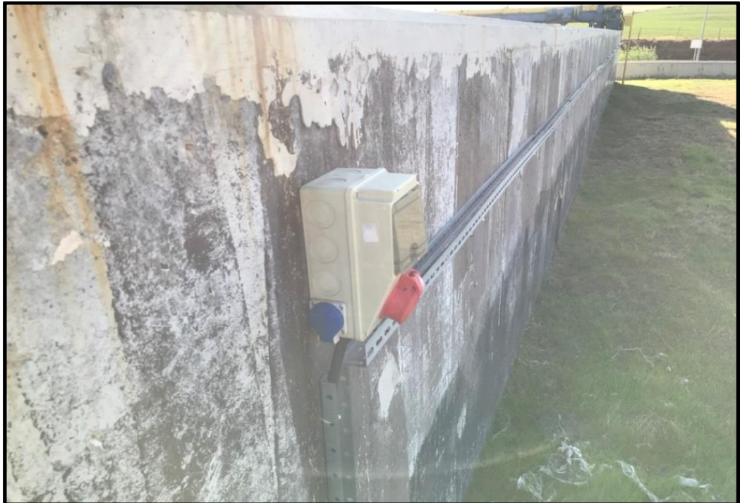
Şekil 4.36. Son Çökeltme Havuz Duvarlarındaki Hasarlar (Kırşehir)
