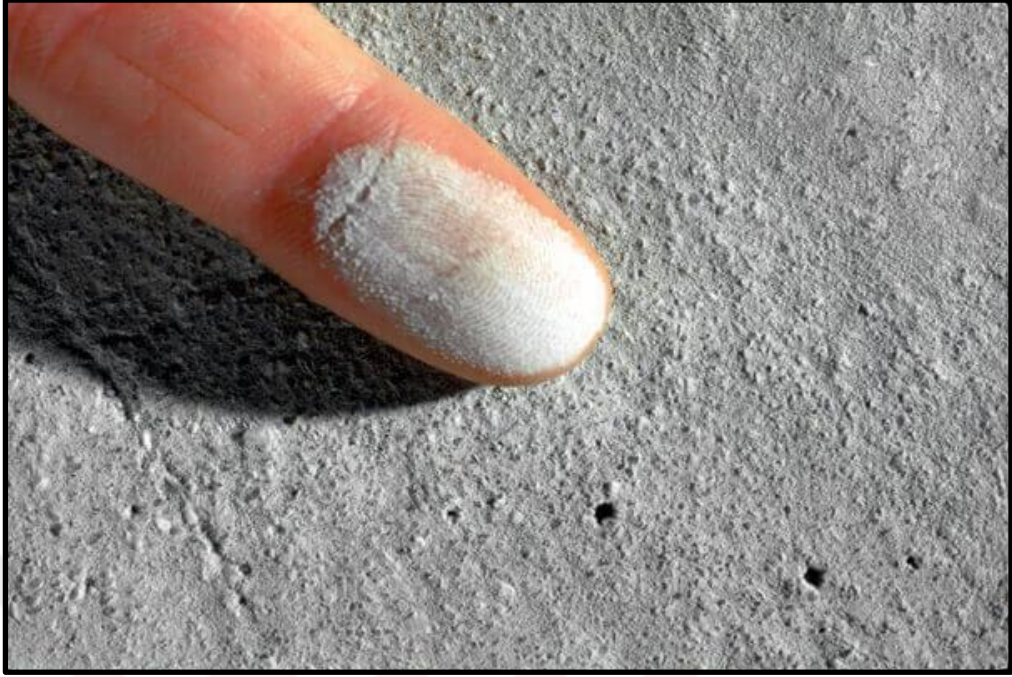
Şekil 2.12. Beton Yüzeyinde Tozuma [1]
