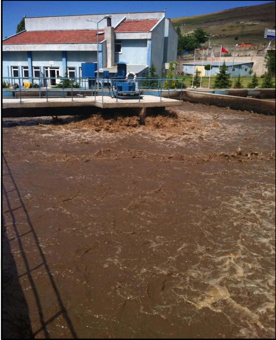
Şekil 3.12. Yozgat Atıksu Arıtma Tesisi – Havalandırma Havuzu
