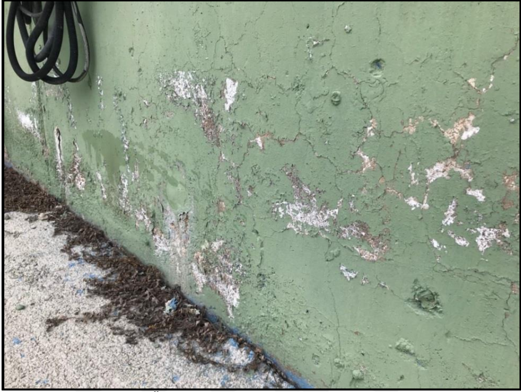
Şekil 4.28. Geri Devir Ünitesinin Bulunduğu Binadaki Hasarlar (Yozgat)
