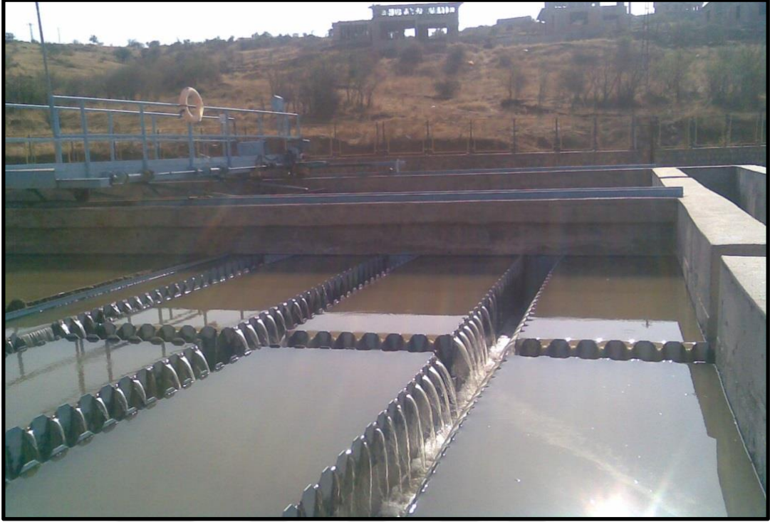
Şekil 3.11. Yozgat Atıksu Arıtma Tesisi – Ön Çökeltme Havuzu
