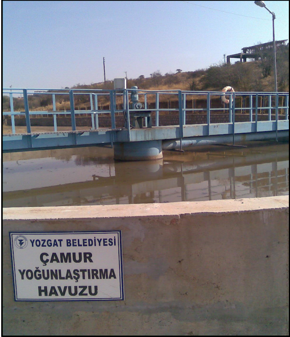
Şekil 3.16. Yozgat Atıksu Arıtma Tesisi – Çamur Yoğunlaştırma Havuzu
