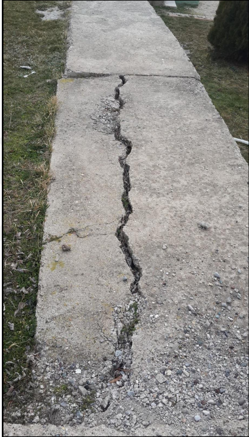
Şekil 4.40. Beton Kanal Kapaklarındaki Hasarlar (Yozgat)
