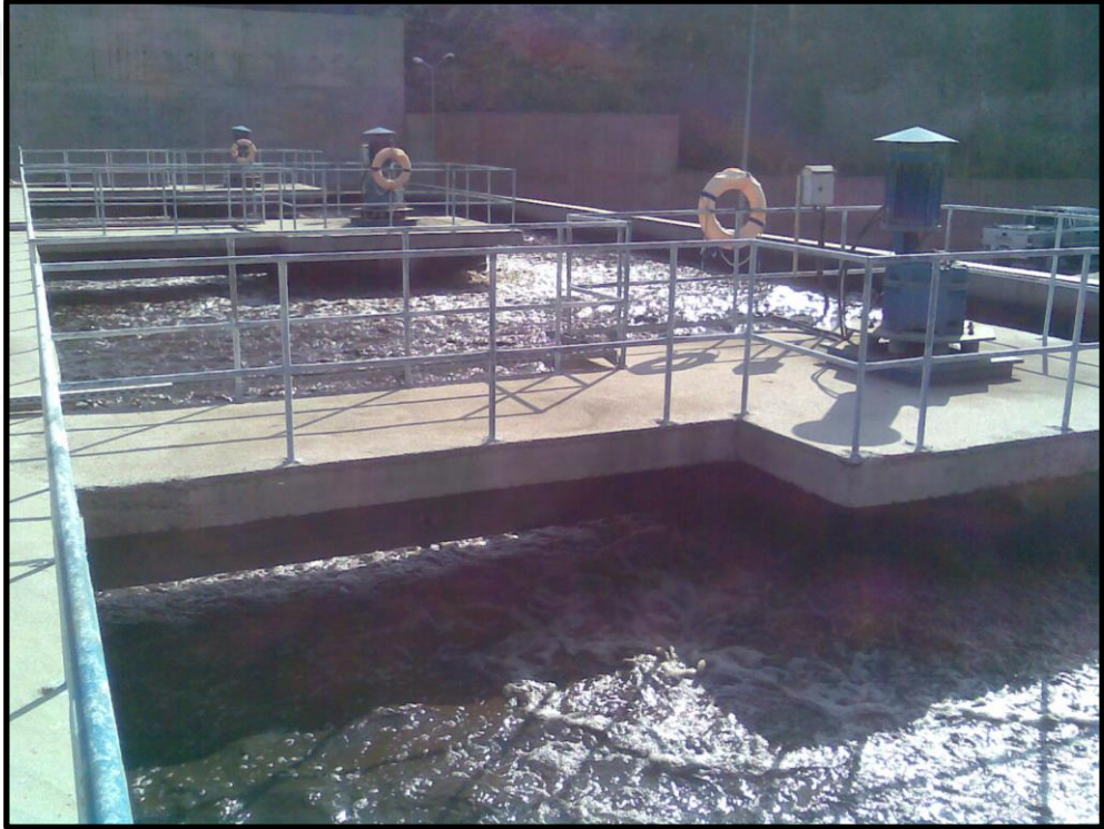
Şekil 3.17. Yozgat Atıksu Arıtma Tesisi – Çamur Çürütme Havuzu
