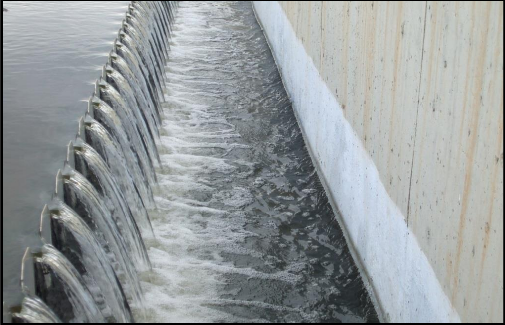
Şekil 3.48. Kırşehir Atıksu Arıtma Tesisi – Durulama Havuzları Çıkışı
