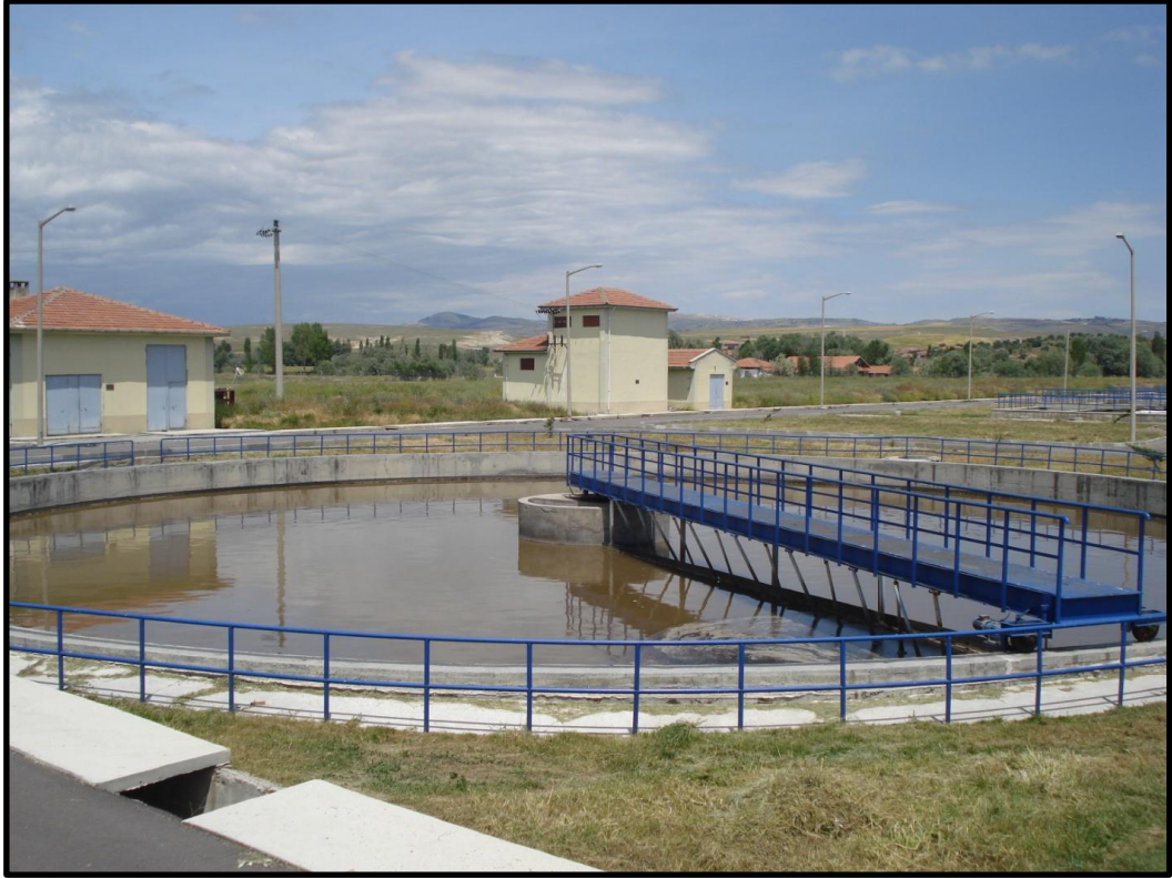
Şekil 3.52. Çorum Atıksu Arıtma Tesisi – Ön Çökeltme Havuzları
