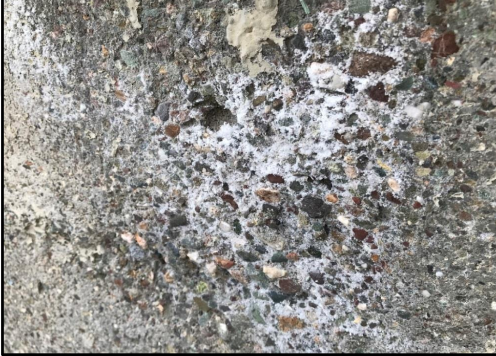
Şekil 4.15. Çamur Yoğunlaştırma Havuzu Perde Duvarındaki Hasarlar (Kırşehir)
