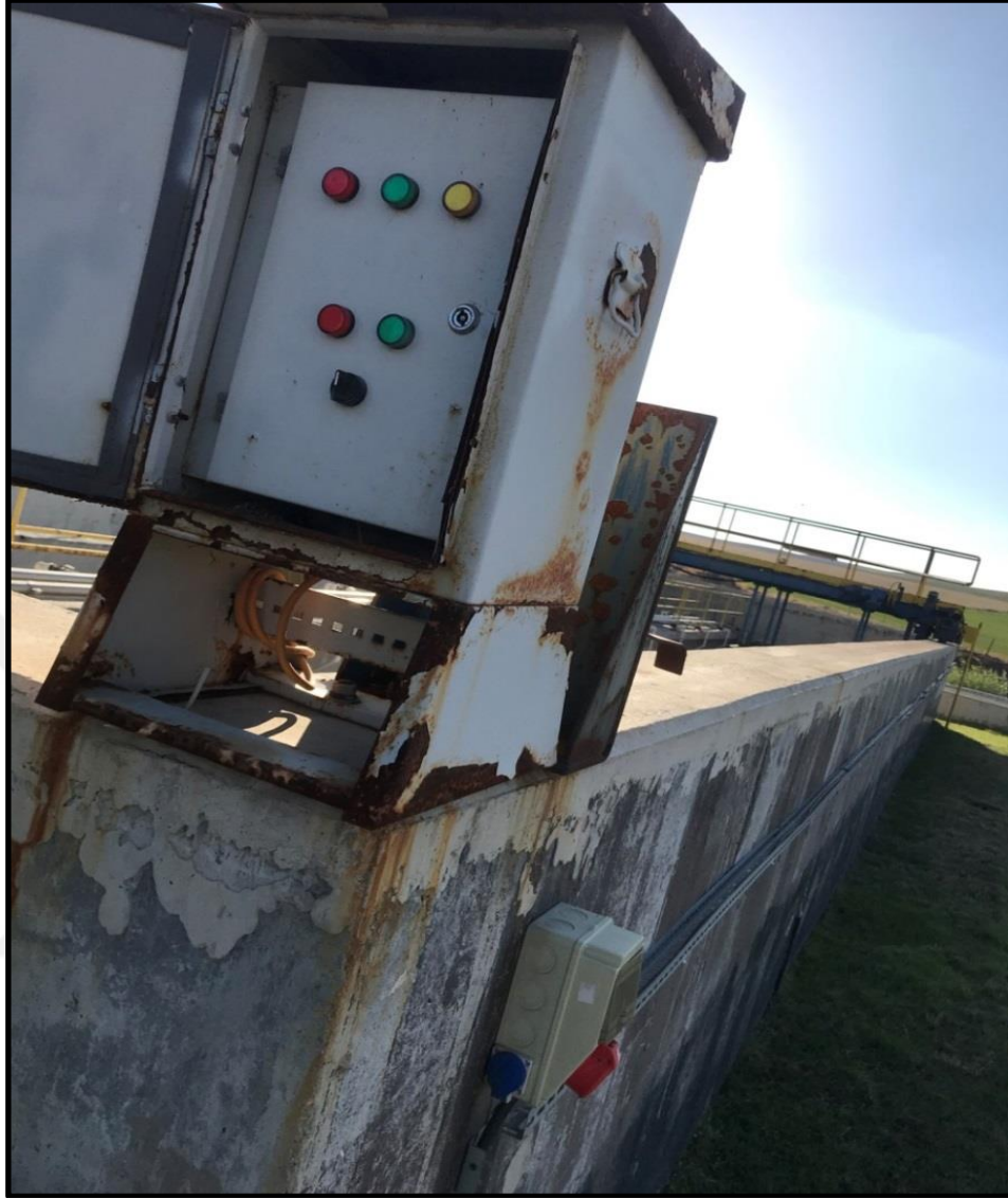
Şekil 4.37. Son Çökeltme Havuz Duvarlarındaki Hasarlar (Kırşehir)
