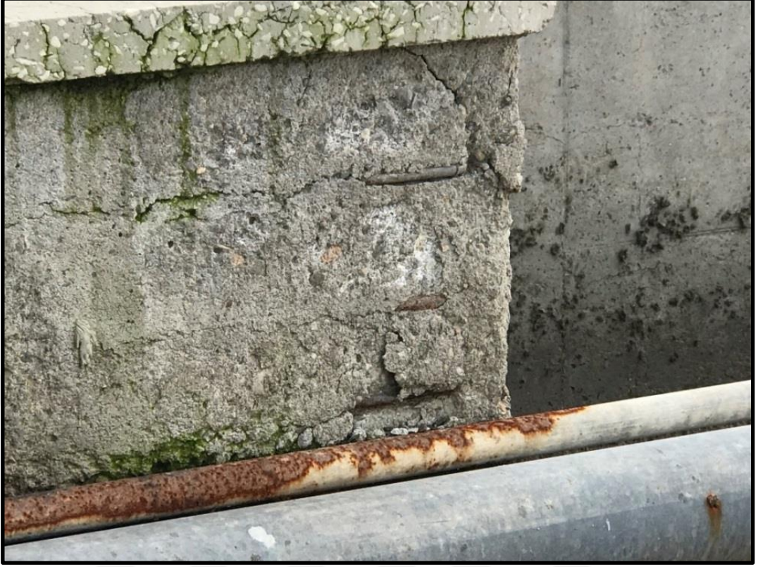
Şekil 4.11. Çorum Korozyona Uğramış Donatı Ve Donma Çözülme Etkisiyle Parçalanmış Beton (Çorum)
