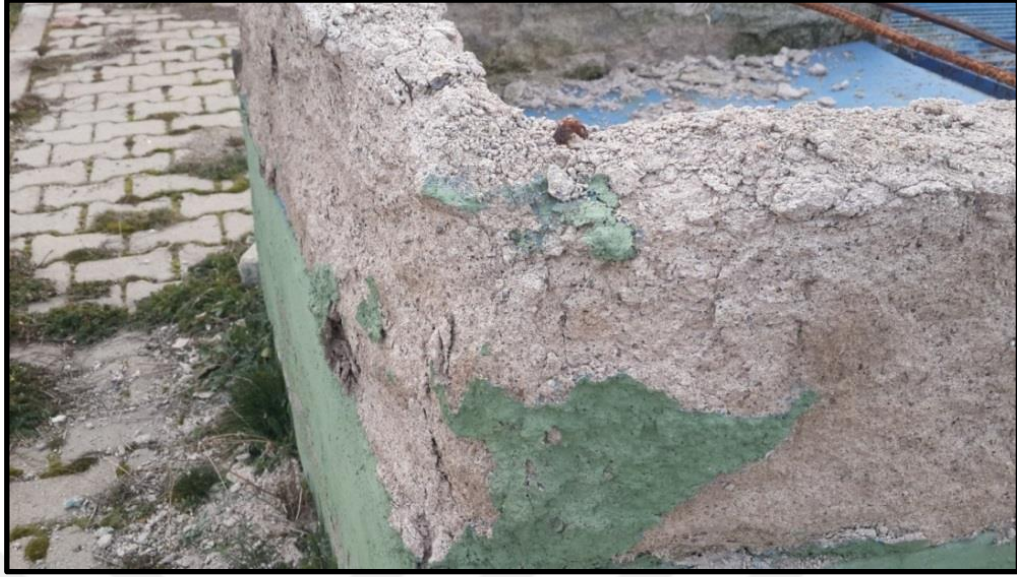
Şekil 4.8. Havalandırma Havuzu Geri Devir Besleme Kanalı Perde Duvarlarındaki Hasarlar (Yozgat)
