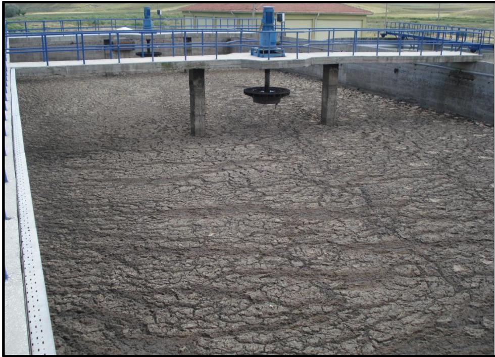
Şekil 3.60. Çorum Atıksu Arıtma Tesisi – Çamur Çürütme Havuzu
