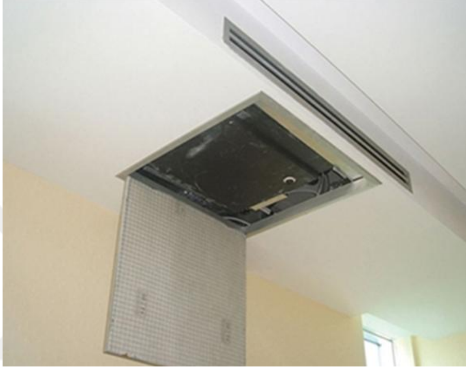
Şekil 3.4. İncelenen Alışveriş Merkezine Ait Bir Fan Coil Görünümü
