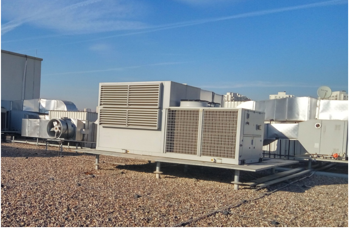
Şekil 3.6. Alışveriş Merkezinde Bulunan Klima Santraline Ait Görünüm
