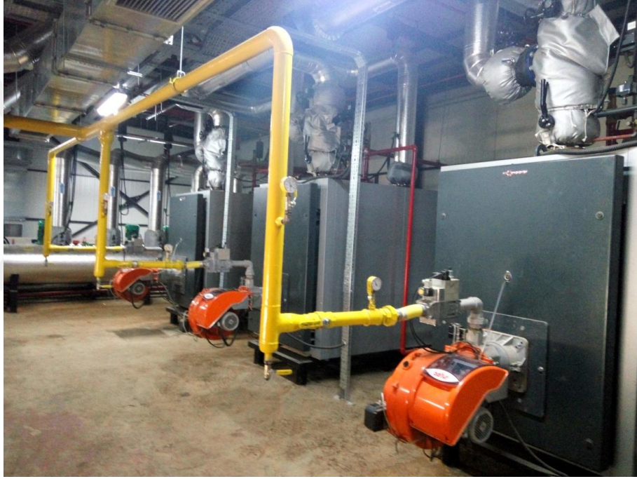
Şekil 3.2. İncelenen Alışveriş Merkezinde Bulunan Kazanlara Ait Görünüm
